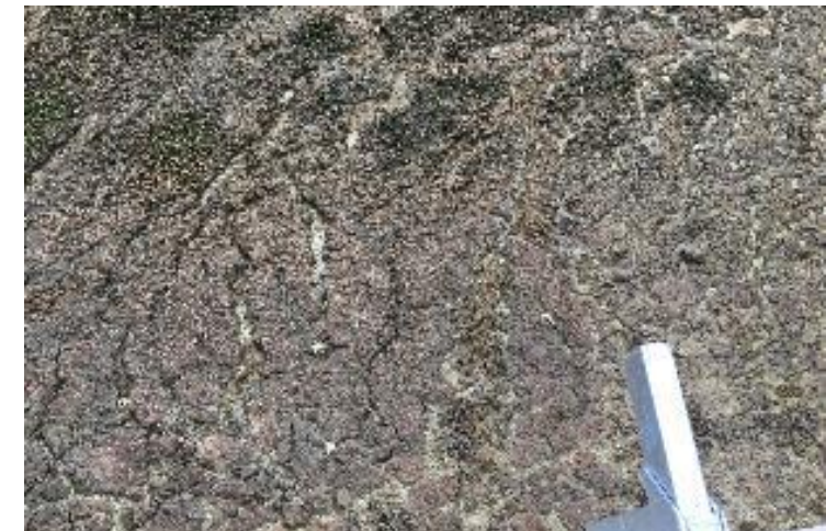
rissige Schwimmschicht, Blasenbildung
