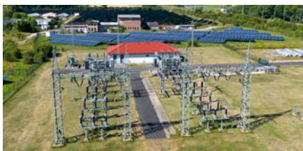
3 In 99752 Bleicherode/Wipperdorf: Umspannwerk Am Heizwerk
