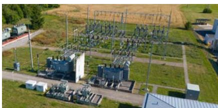
9 In 98646 Hildburghausen: Umspannwerk Weitersrodaer Straße
